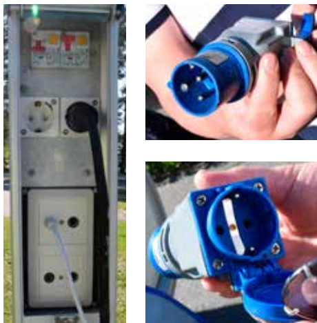
Stolpe med jordat eluttag 10A och kabel-TV. Enligt ny elstandard krävs jordfelsbrytare och gummikabel med CEE-märkta, blå kontakter, ledararea 2,5 mm 2 , och max 25 meter längd.
